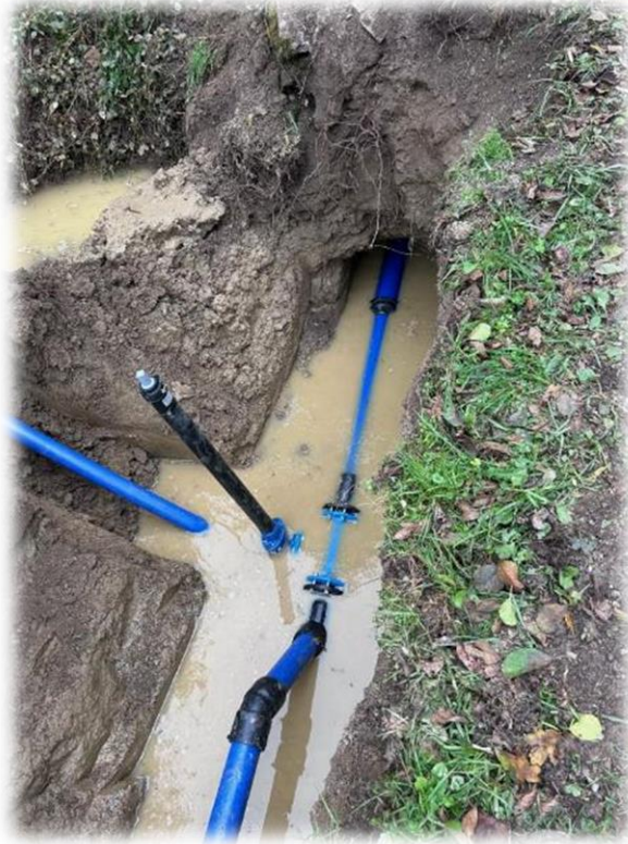
Blatnik in vodovodna cev v zaščitni cevi pod prepustom skozi cesto.
