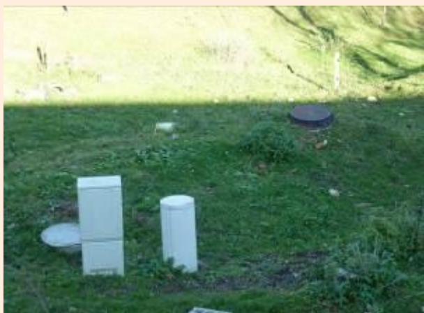
Slika 22: Mala čistilna naprava Novi Pot
