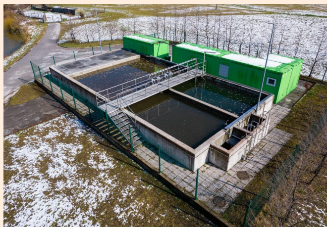
Slika 20: Čistilna naprava Sodražica
