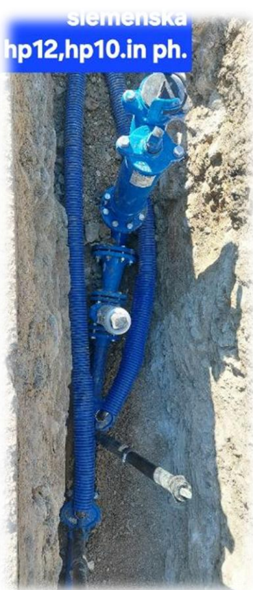
Slika 19: Podzemni hidrant na Slemenski cesti
