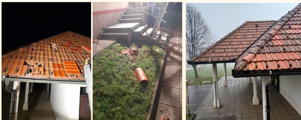
Slika 30: Poškodbe strehe zaradi neurja na mrliški vežici Sveti Gregor
