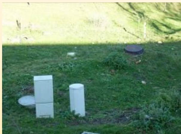
Slika 22: Mala čistilna naprava Novi Pot
